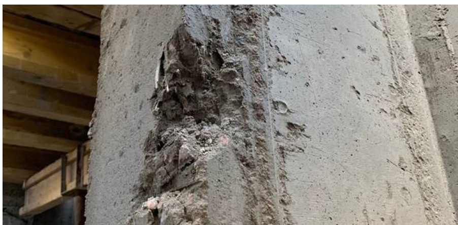
Рис. 2. Разрушение участка стены при распалубливании
