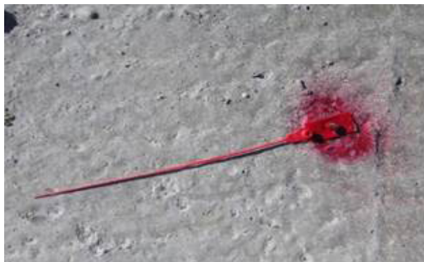
Рис. 2. Дюбель в бетоне с открасом
