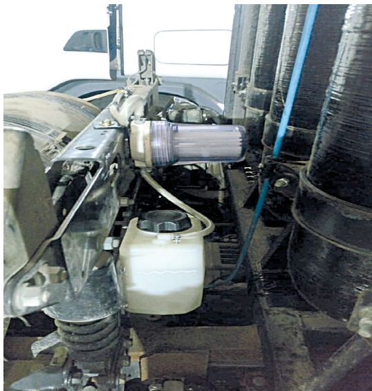
Рис. 3. Резервуар для хранения электролита, фильтр, а также газовые баллоны, в которых хранится метан
