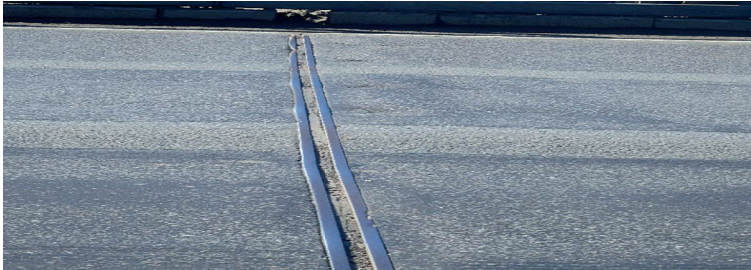
Рис. 2. Абразивный износ покрытия в переходной зоне
