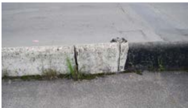
Рис. 2. Деградиционное разрушение конструкции блоков парапетного ограждения
