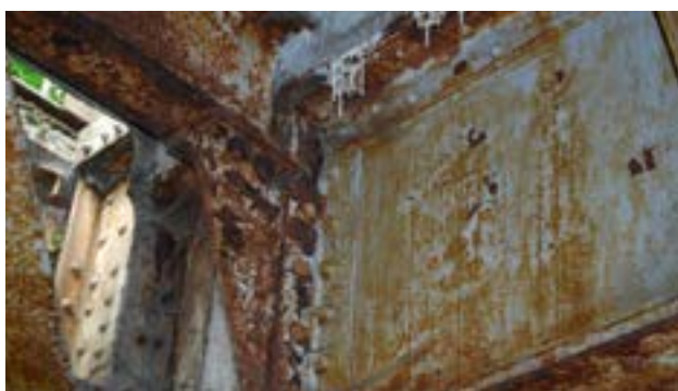
Рис. 4. Выщелачивание цементного камня из железобетонной плиты с образованием сталактитов. Коррозия металлических элементов пролетного строения
