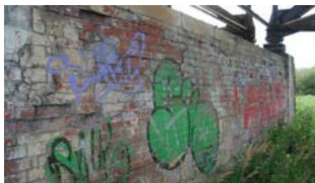
Рис. 5. Расстройство внешнего ряда кирпичной кладки (вывалы, трещины)
