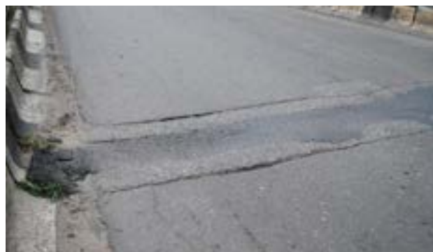
Рис. 3. Неровности в области деформационных швов
