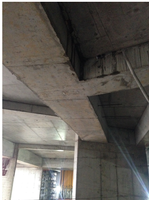
Рис. 3. Поверхности конструкций ЗСД до обработки
