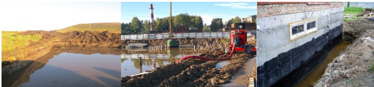
Рис. 1. Примеры заполнения выемок грунтовыми и поверхностными водами, замачивания грунта
