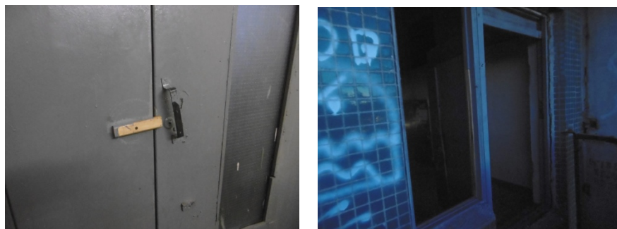
Рис. 2. Состояние противопожарных дверей 2 типа на 24.03.2017 г. Слева направо: «обеспечение глухого притвора», входы на лестницу Н1 и на чердак
