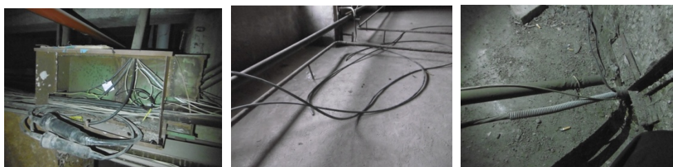
Рис. 4. Состояние проводки на техническом этаже. В центре разделанный кабель Ростелекома. Справа ввод кабеля 380 вольт
